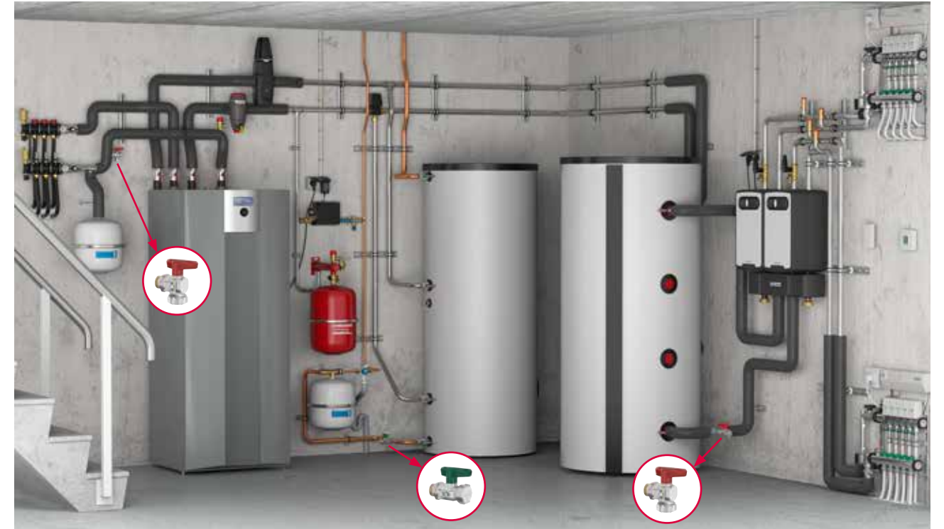
Приклад: маленька котельня
